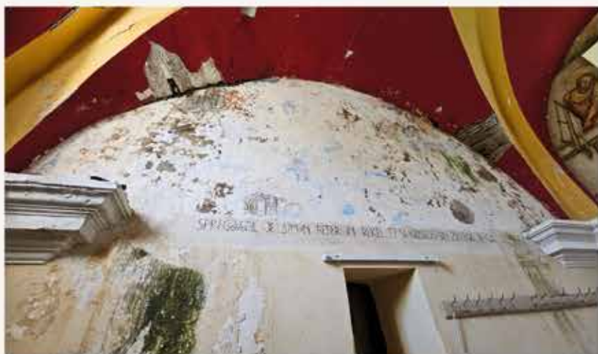
Mesto odstranjene Kraljeve poslikave na koru, ki je, zaradi slabega stanja strehe konservirana.
